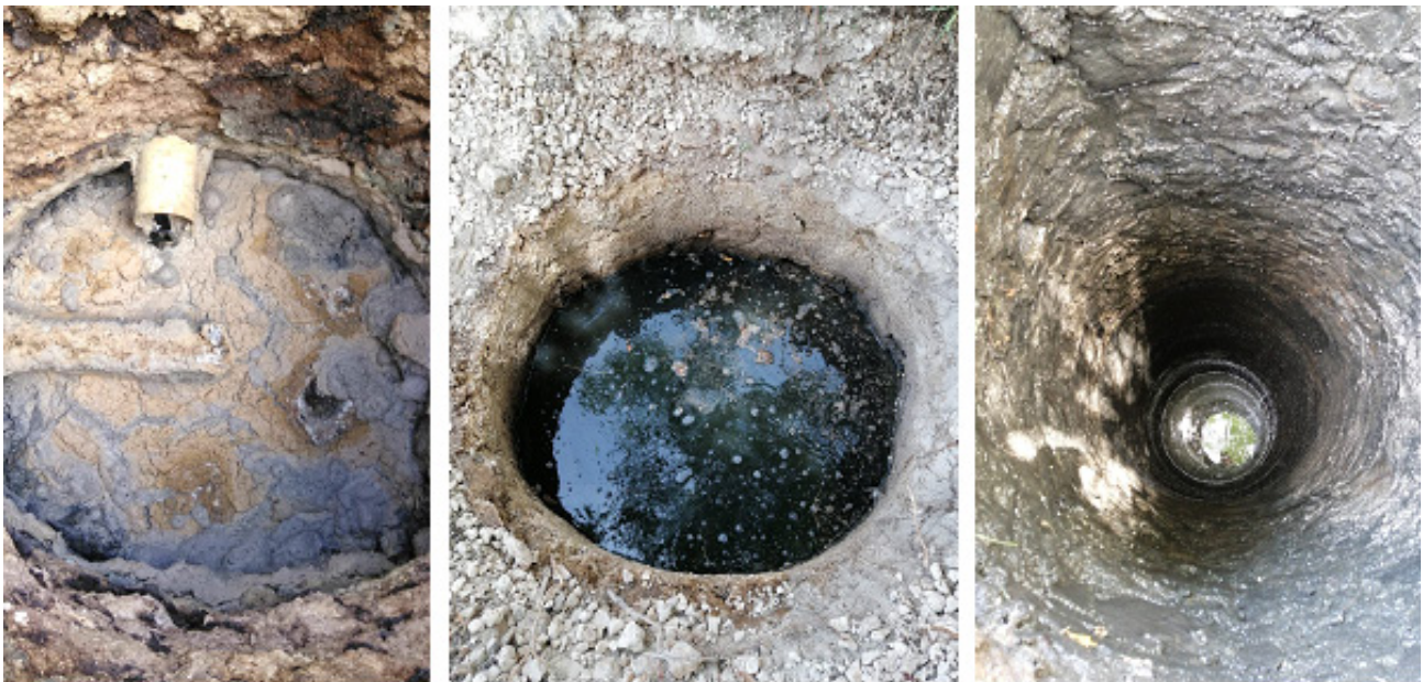
Figura 1. Izquierda: Fotografía de un pozo de absorción saturado e impermeabilizado por grasa y aceites. Central: Fotografía de un pozo absorción saturado e impermeabilizado por lodos espesos. Derecha: Fotografía de un pozo absorción después de un tratamiento de Biodrop Bloque y mantenimiento del equipo de SINBIO. Regresó la absorción del agua en las venas.
