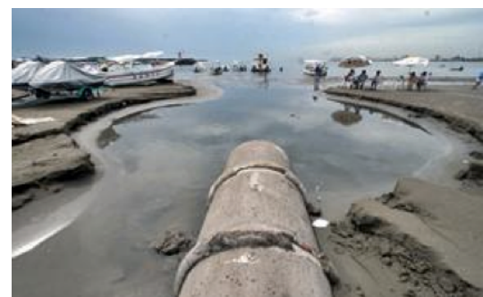
Agua contaminada por presencia de hidrocarburo
