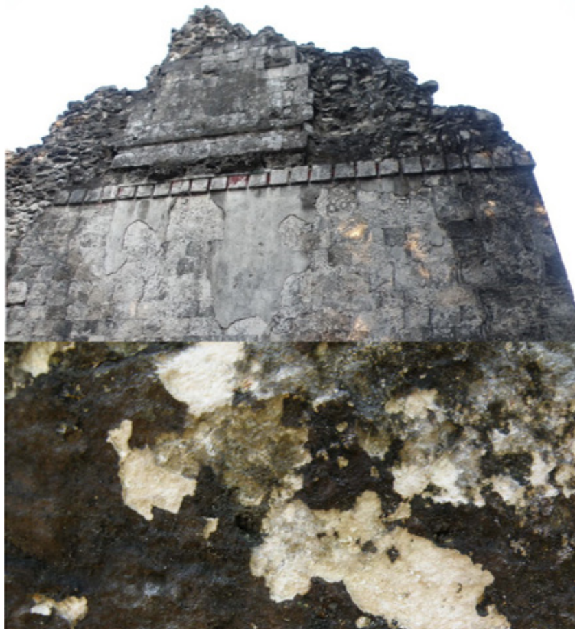
Figura 3. Biopelículas epilíticas (subaereas) desarrolladas sobre sustratos calcáreos, nótese la presencia de la biopelícula como alteración de color negro en superficies expuestas a una permanente radiación. El desprendimiento del biofilm provoca erosión del sustrato calcáreo expuesto (sustrato blanquecino). (Imagen propia).
